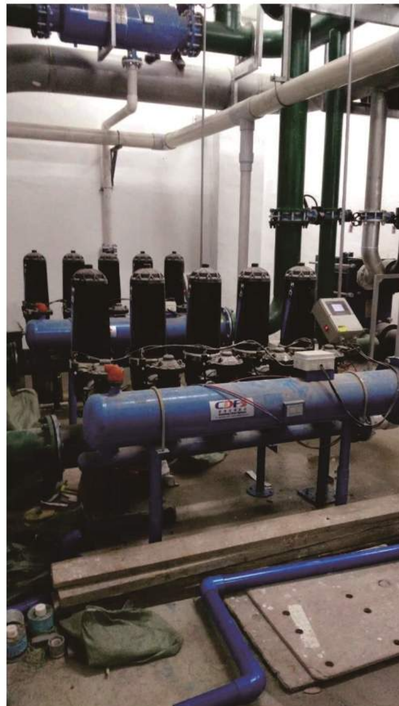
游泳池源水过滤
